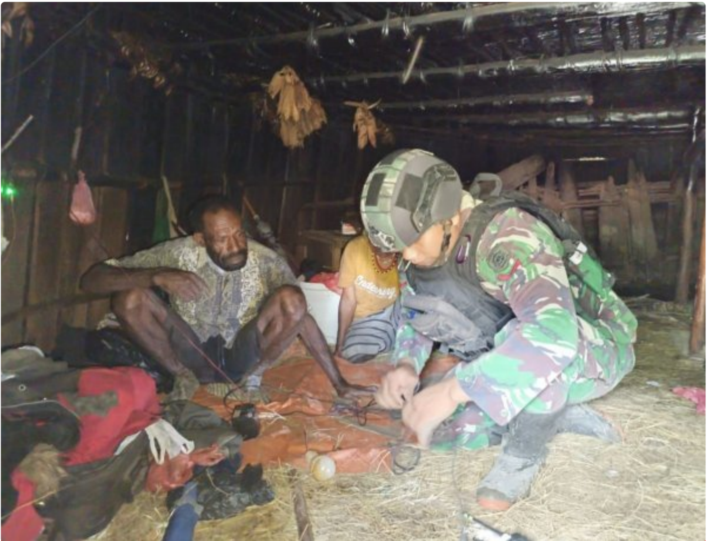
Foto: Satgas Yonif 323/BP TK Wuloni Memperbaiki Instalasi Listrik Dan Lampu Penerangan di Rumah Warga Kampung Wuloni, Distrik Ilaga Utara, Kabupaten Puncak, Papua, Sabtu (20/06/2024).
